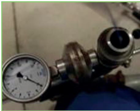
Photo 1 : Vanne de sortie (haut de la cloche) de la centrifugeuse (zone P2 figure 3)
